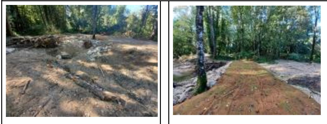
Fosse d'enfouissement des terres contaminées par la renouée. Création du bouchon et du tracé conservé
